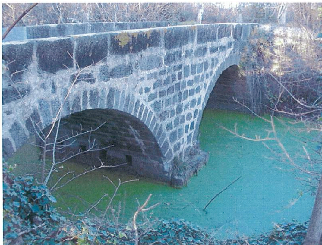
Le pont "Saint Bauzély" qui enjambe en deux arches le Rieu Mort (ex Ruisseau de Courredouce).
