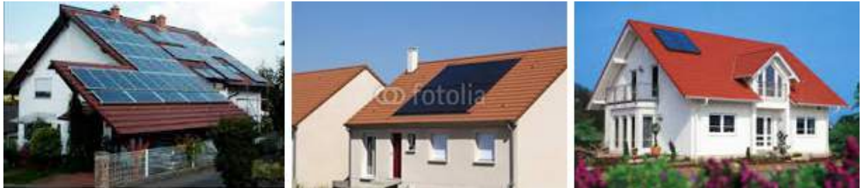
la pose de panneaux solaires en toiture produit le plus souvent un « mitage » des toitures
