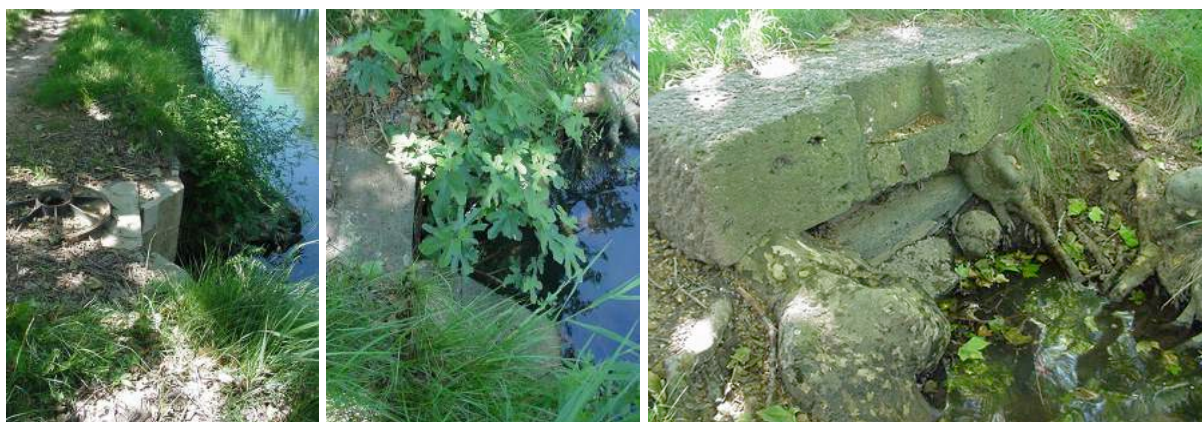
Trois ouvrages différents dont un, à gauche de facture récente avec "tampon fonte".
