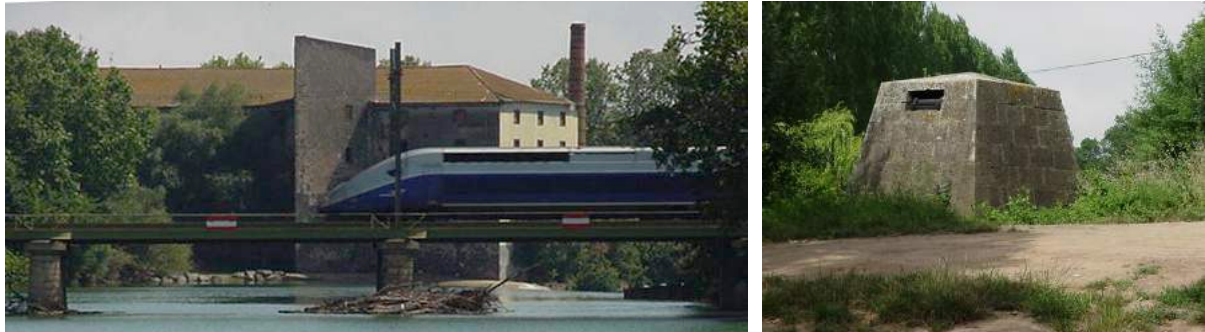
Vue du barrage de la Pensière depuis le cours supérieur de l'Hérault. En arrière plan : le Moulin des Evêques (XIIIe siècle) caractérisé par sa tour en éperon. Lourde culée bâtie en pierre basaltique susceptible de reprendre les efforts transmis par un câble traversant la rivière et grâce auquel les chalands rejoignent le bief de l'écluse de Prades ; la traversée de la rivière se faisant comme pour un bac.
