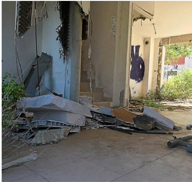
L'intérieur des bâtiments, squaté depuis des années, a été endommagé.
